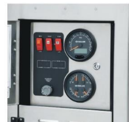
Система мониторинга и контроля Интуитивно понятная панель управления (расположена в защищенном от атмосферного воздействия корпусе) предоставляет информацию о системе в реальном времени.
